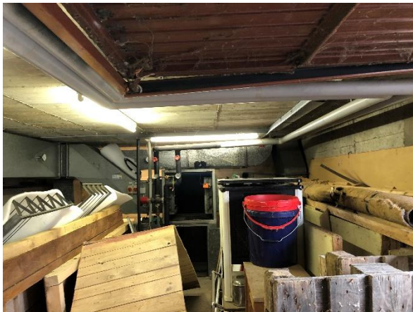
Abb. 7: Keller mit Entlüftungsanlage wird als Lagerstätte genutzt
