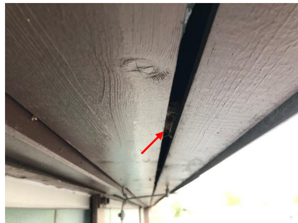
Abb. 12: Nischen und Spalten im Dachüberstand mit Vogelnest (roter Pfeil)
